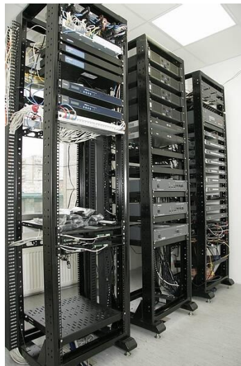
Figure 21 : Exemple de baie de brassage
